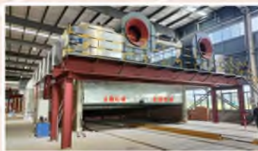
Туннельная печь D&S с внутренней шириной 9 м
